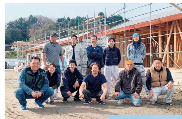
能登半島で応急仮設木造住宅の建設に従事する神奈川土建の仲間
